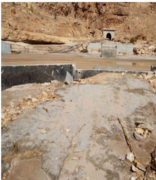
Suite aux inondations
