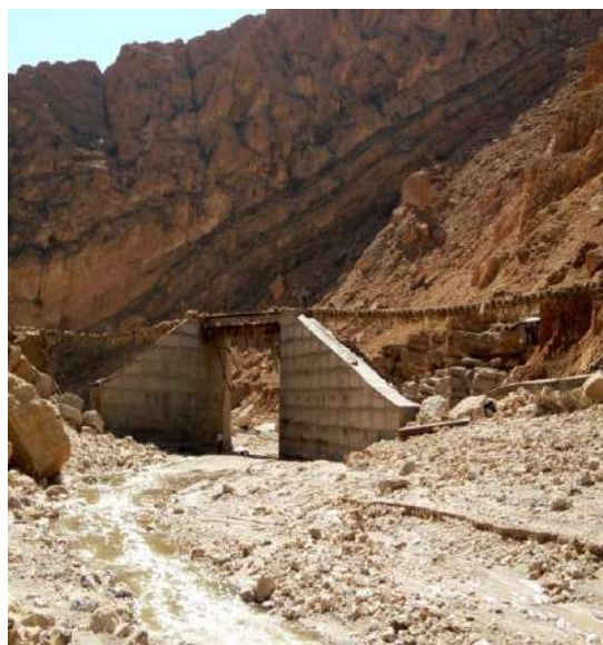
Suite aux inondations
