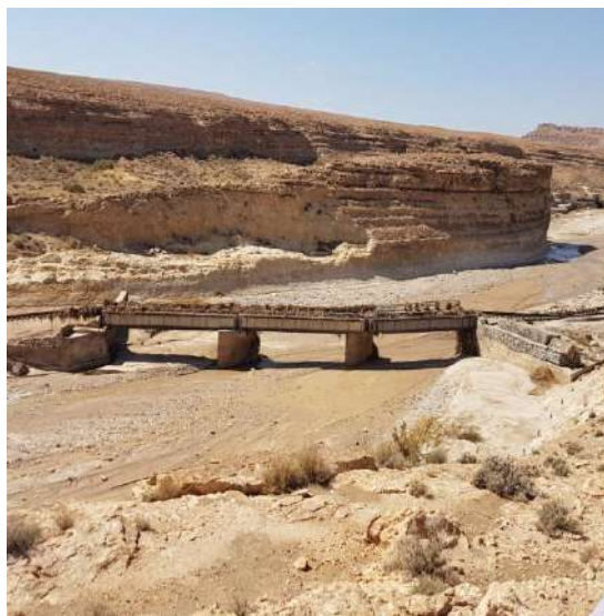
Suite aux inondations
